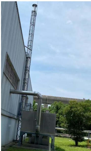
危废库活性炭吸附装置
