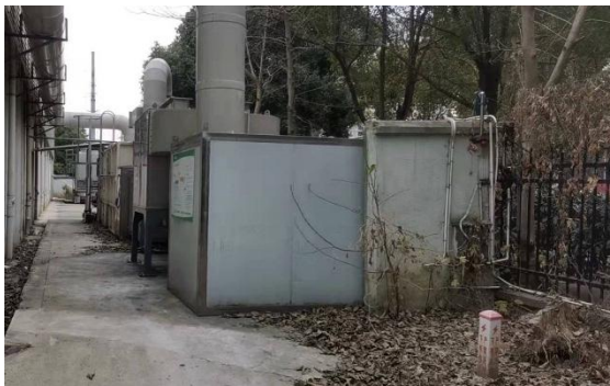
污水处理站废气处理装置
