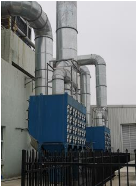
车身车间滤筒除尘装置
