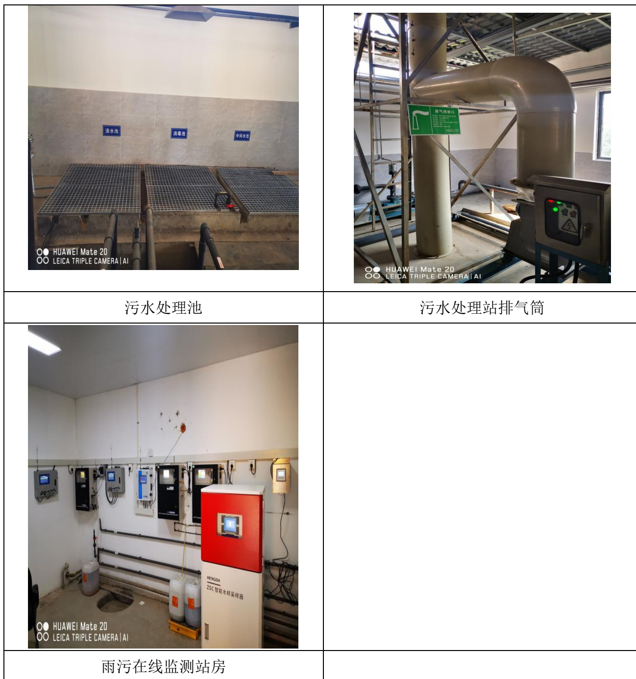
图 4.1-3 废水治理设施
