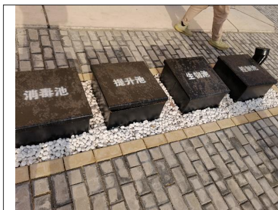
图 6.2-1 一体化污水处理装置
