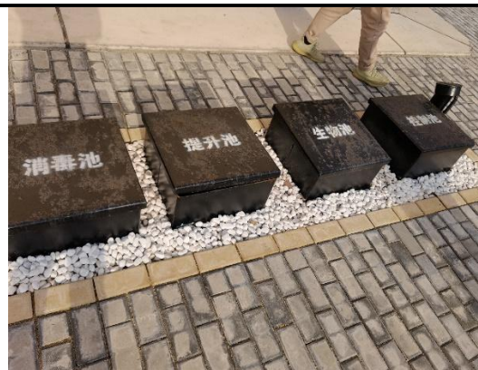
图 4.1-20 地埋式生活污水处理设施
