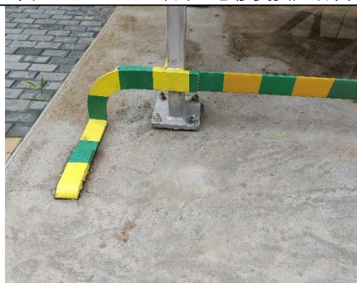
图 4.1-23 高压接地装置
