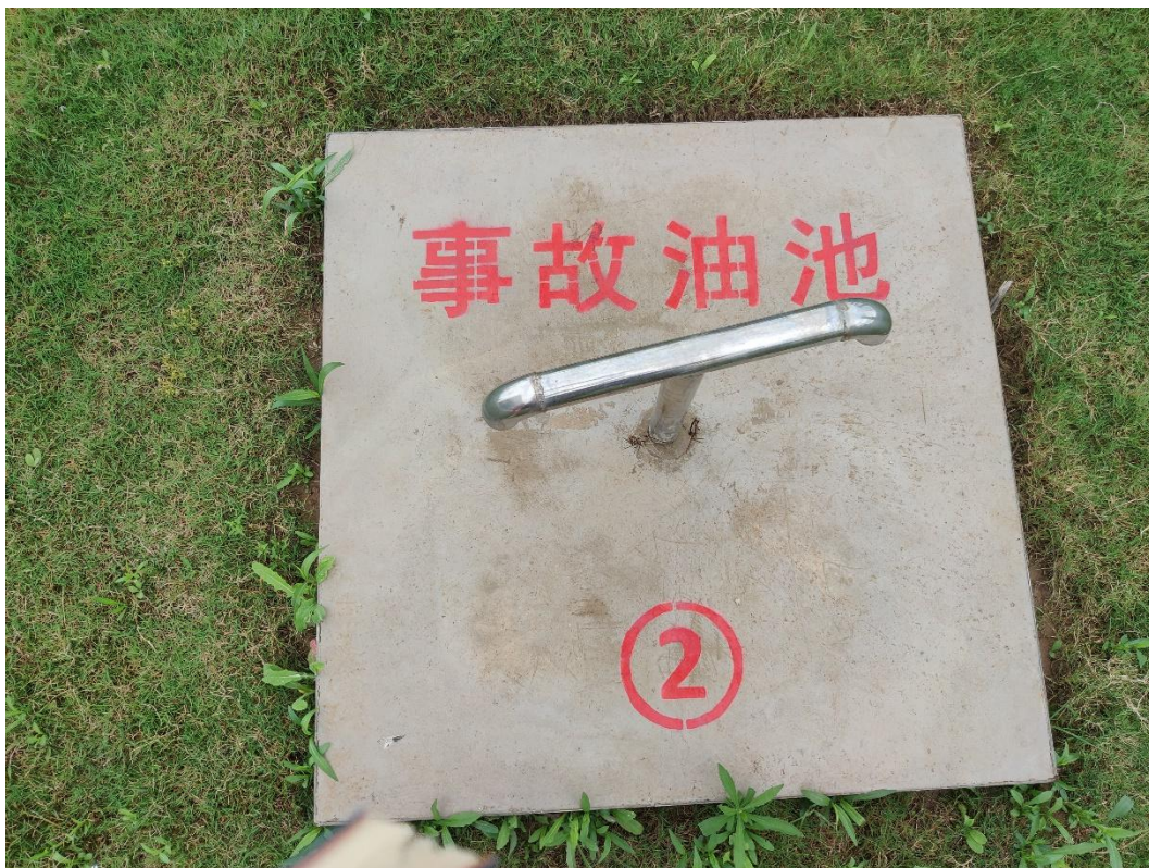
图 2.2-11 集控中心事故油池
