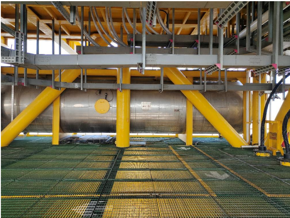
图 2.2-14 海上升压站事故油罐
