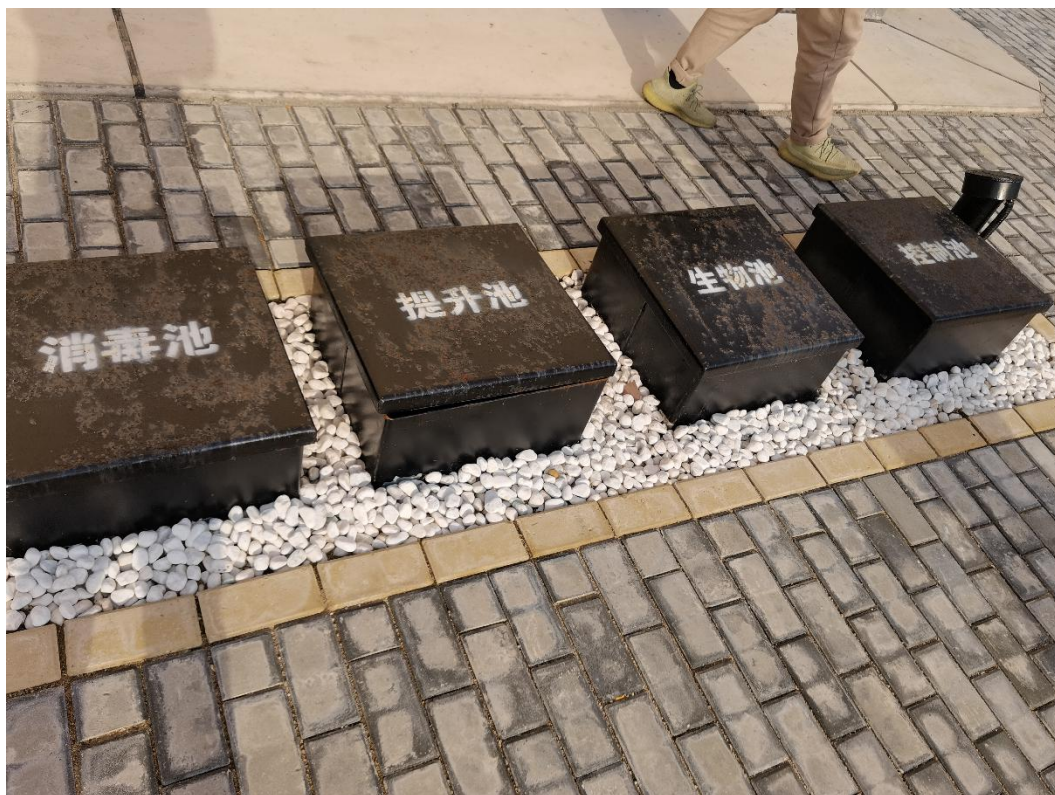
图 2.2-12 集控中心生活污水处理设施
