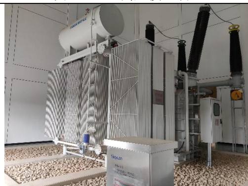
图 4.1-25 主要设备位于室内
