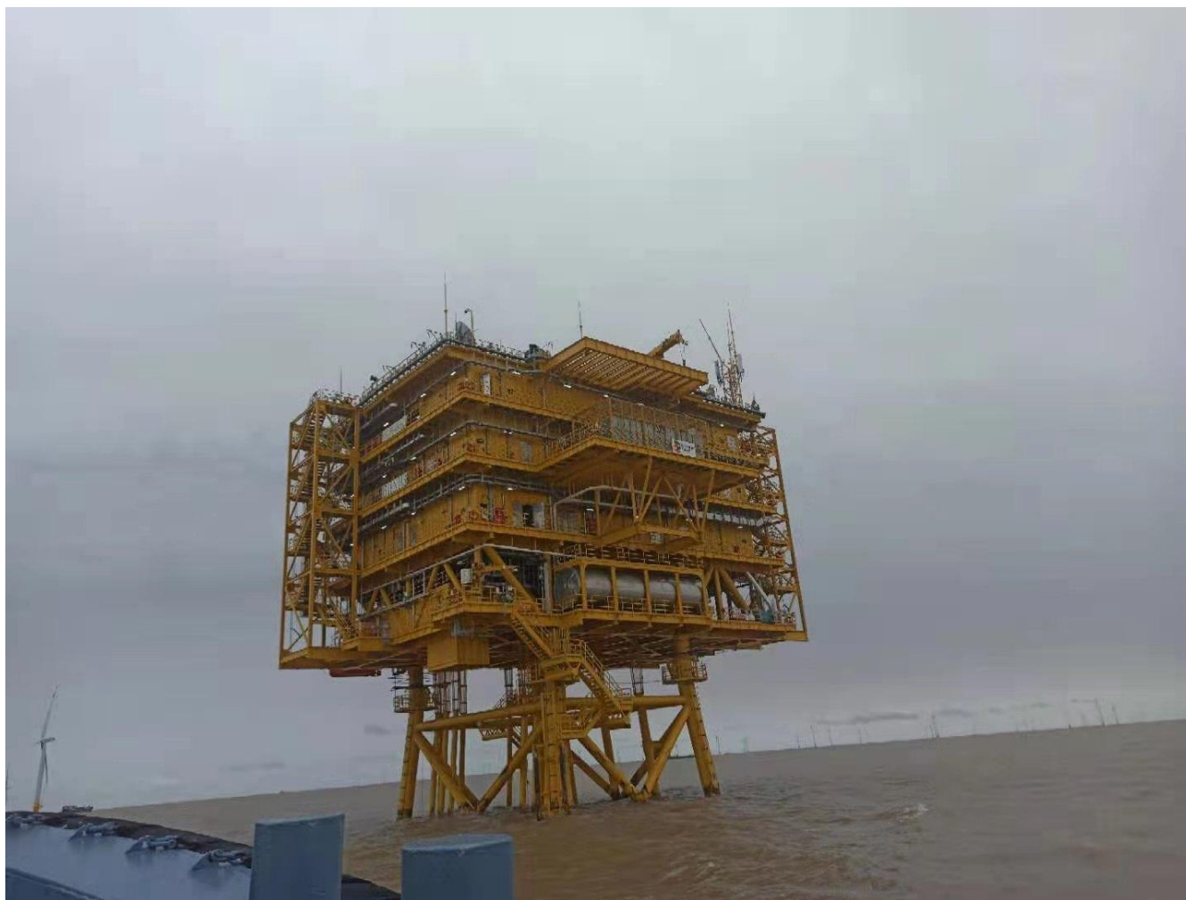
图 2.2-8 海上升压站现状图
