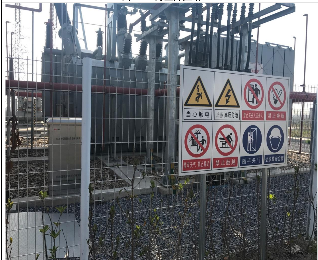
图 3-4 集控中心变压器
