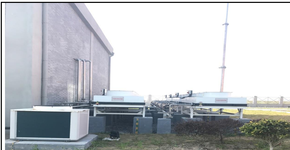
图 3-5 集控中心无功补偿冷却水风机
