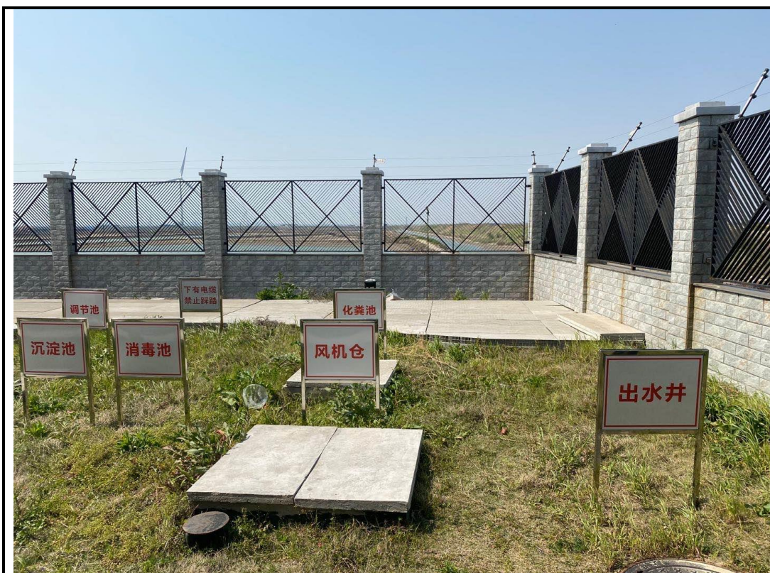
图 5.3-1 集控中心地埋式生活污水处理设施
