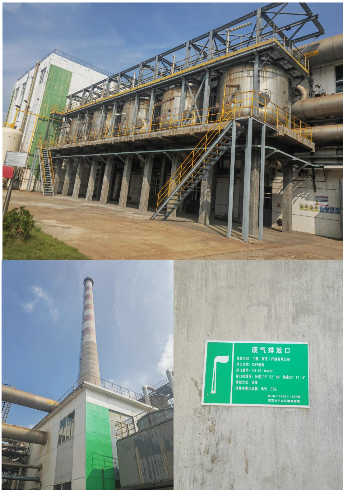
图 4.1-5 CAP 装置及 FQ-02 排口
