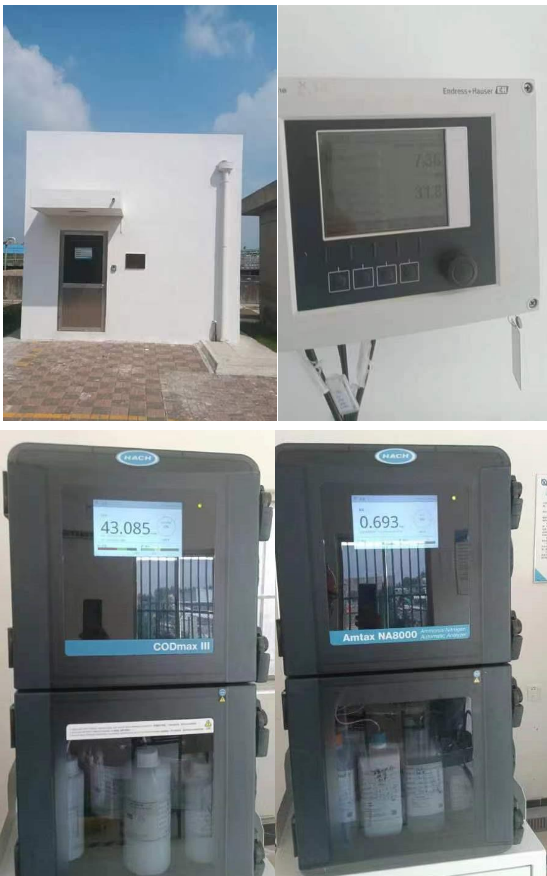
图 4.2-2 废水在线监测设施现场照片
