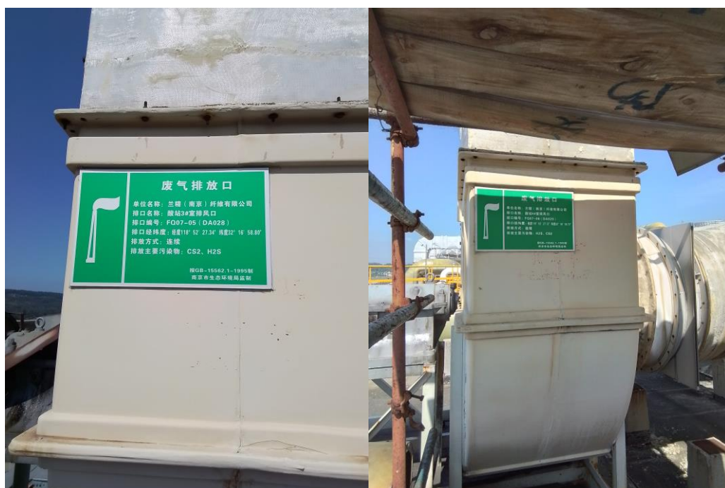
图 4.1-8 车间室排风废气排口
