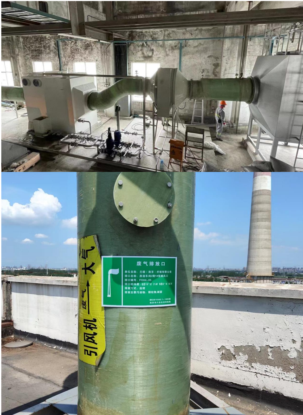
图 4.1-6 碱喷淋+活性炭装置及 FQ04-05 排口
