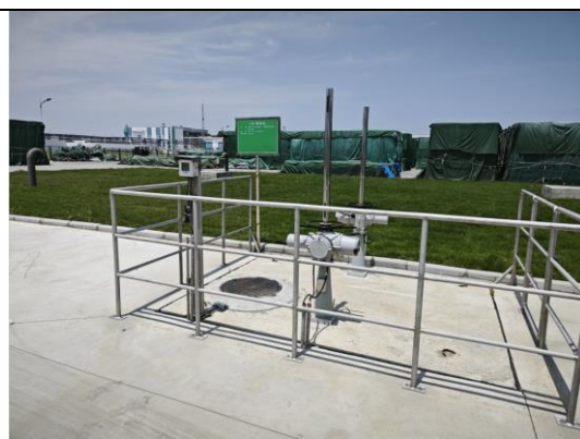
初期雨水兼事故池
