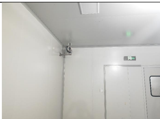
贮存设施视频监控
