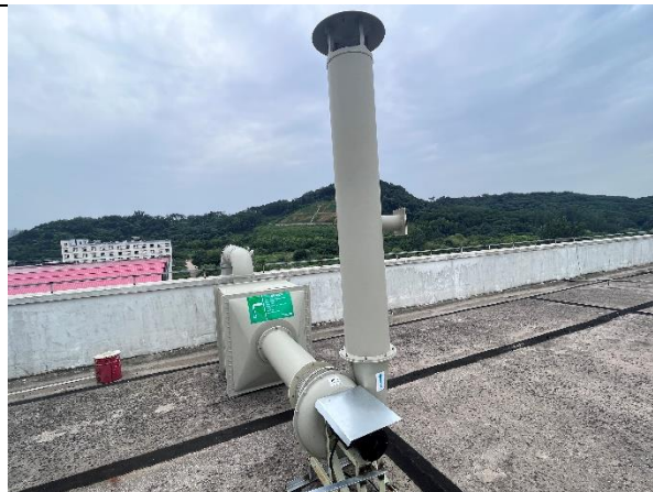
危废库废气排口 FQ-02 (DA002)
