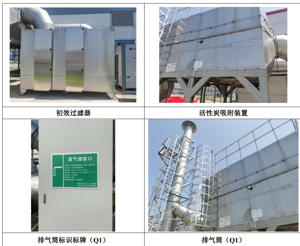
图 3-3 废气处理装置及标识标牌
