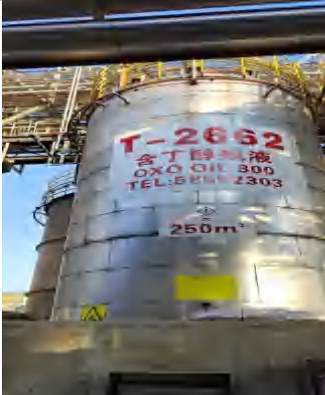
图 4.1.3-1 丁醇残液储罐（T2662）照片
