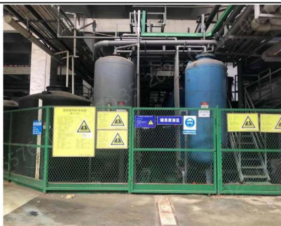
危险废物贮存设施（第 4-3 号）
