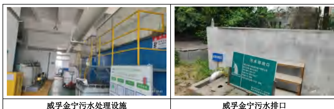
图 3-3 污水处理设施及标识标牌（依托）
