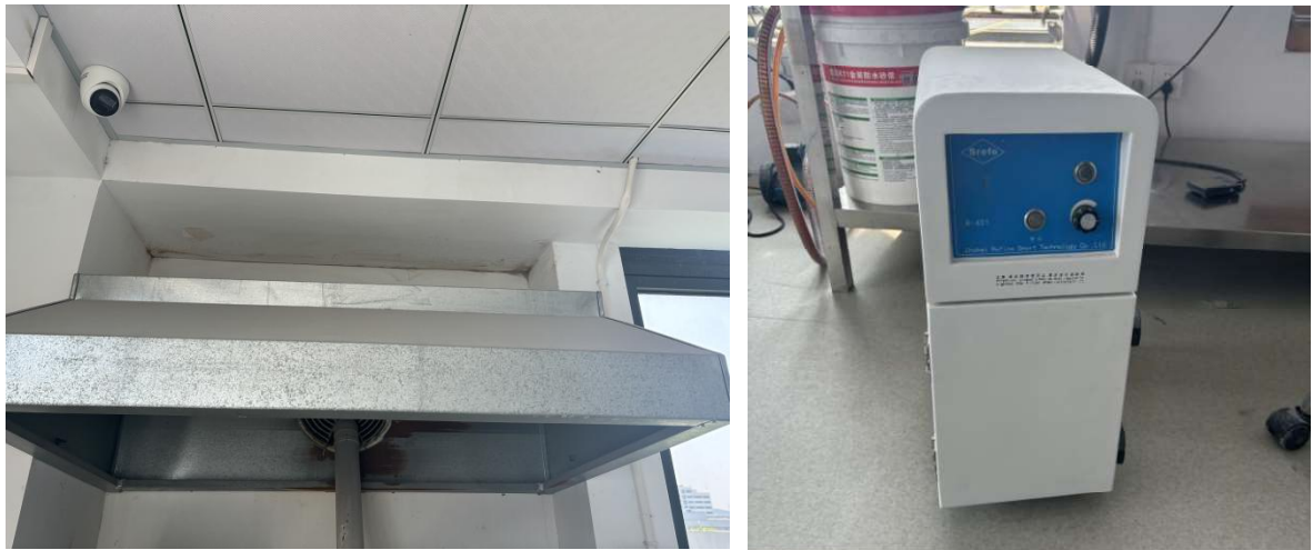
图 3-1 废气治理设施
