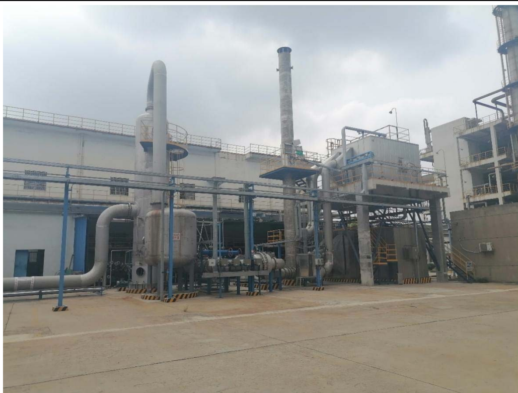
废气处理设施照片
