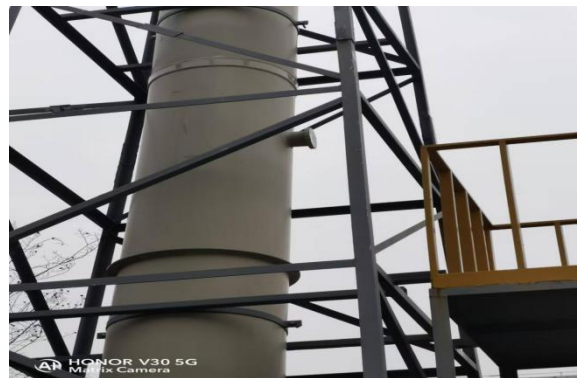
抛光、清洗废气排气筒取样口
