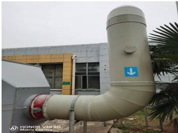
抛光、清洗废气进气取样口
