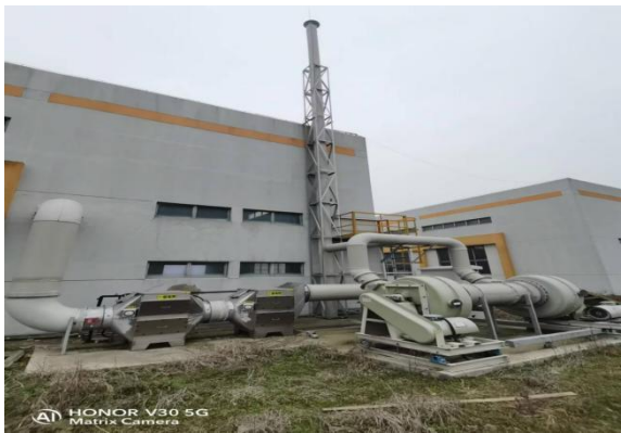
危废库废气处理设施两级活性炭装置
