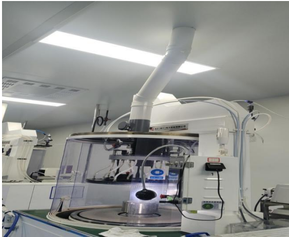
抛光机废气收集管道
