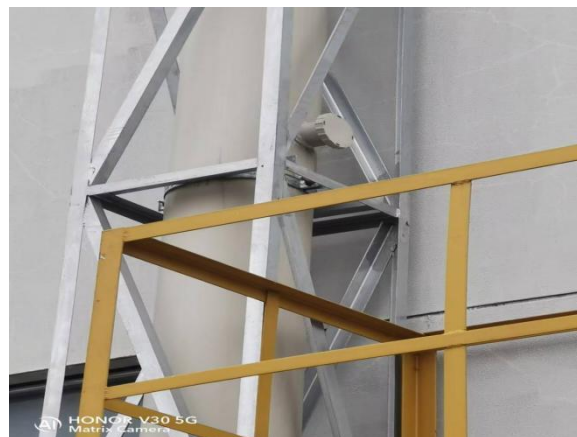
危废库废气处理设施排气筒取样口
