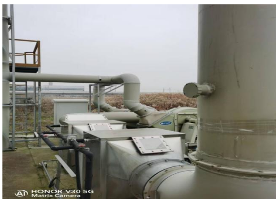
危废库废气处理设施进气取样口
