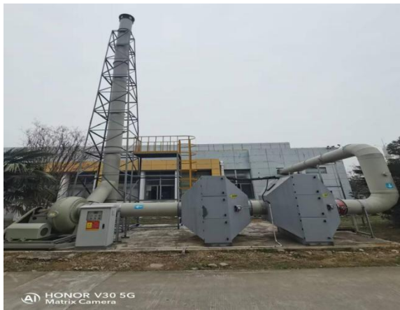
抛光、清洗废气两级活性炭装置
