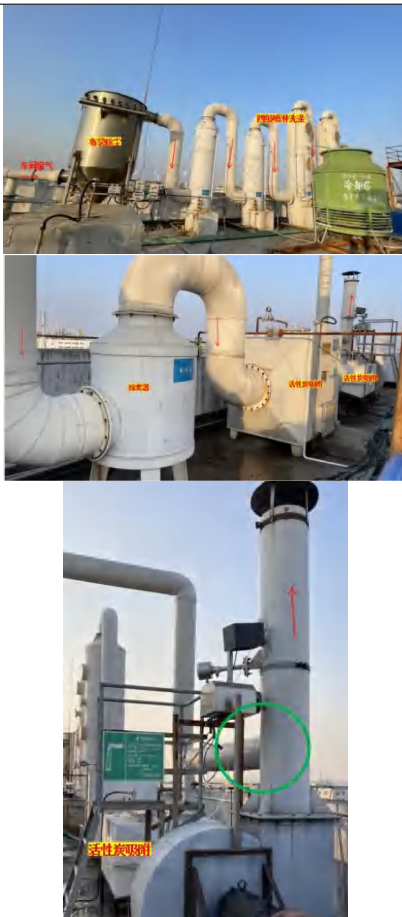
图 3-3 废气处理装置及标识标牌
