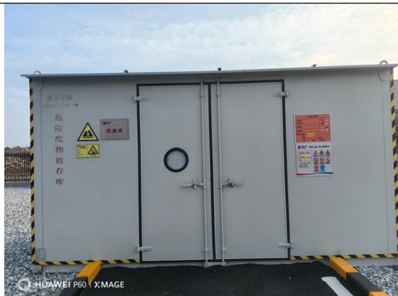
图 6.5 危险废物一体式库房（正面）
