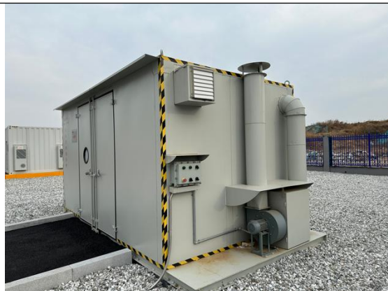
图 6.6 危险废物一体式库房（侧面）
