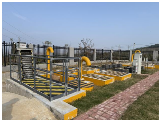
图 6.4 陆上集控运维中心地埋式污水处理设施
