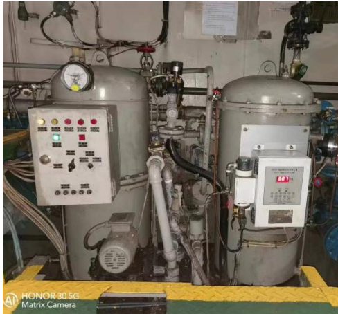
施工船舶生活污水处理装置
