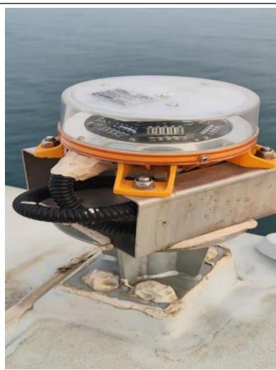
海上风机顶端照明设施
