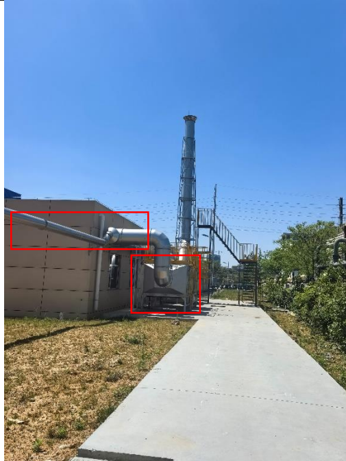
危废库废气收集、处理装置
