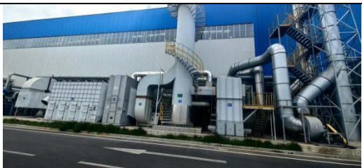
箱体擦拭、喷漆、烘干、喷枪清洗废气处理装置
