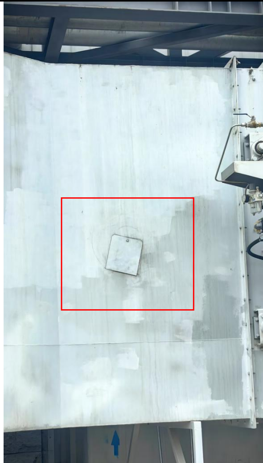
箱体擦拭、喷漆、烘干、喷枪清洗废气进口采样孔
