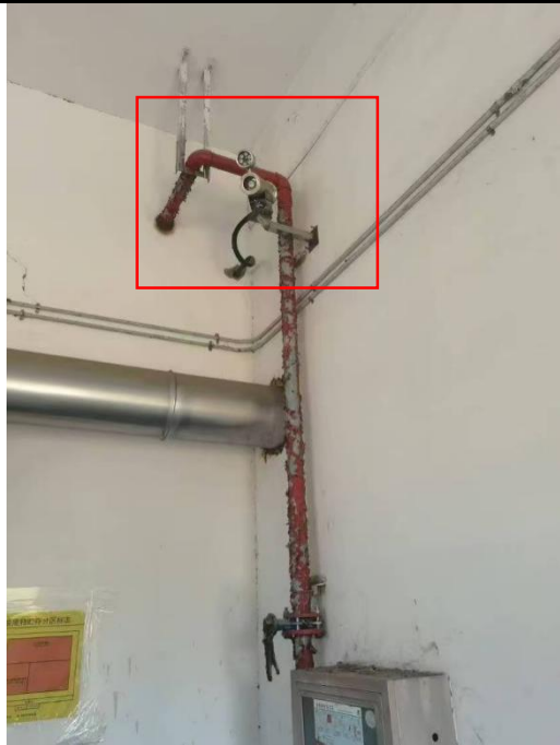
危废暂存间的内部摄像头
