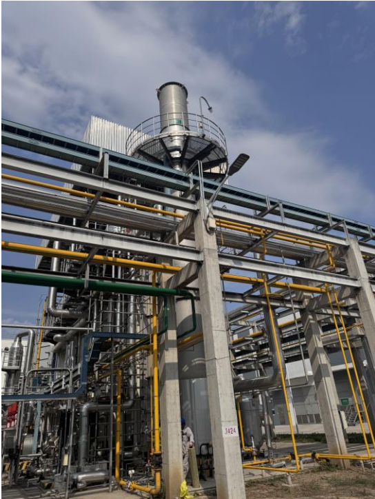
燃气轮机组排气筒
