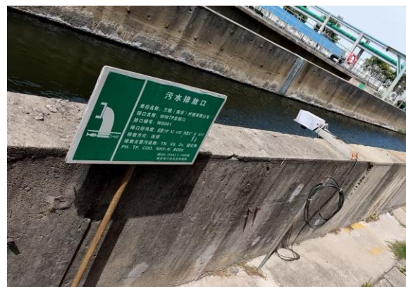
污水排污口标识牌
