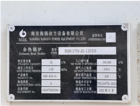
余热锅炉铭牌
