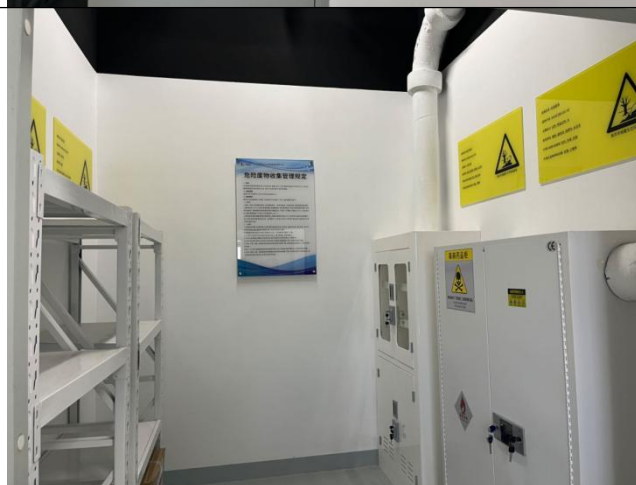
危废库内部分区标识牌
