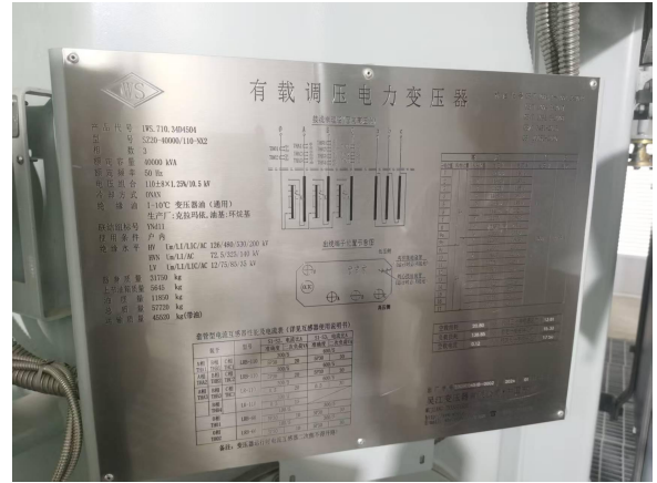
110kV #1 主变铭牌
