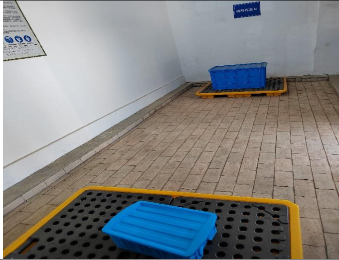
酸类物品储存区防控措施（地面防腐+防渗托盘+截流沟）
