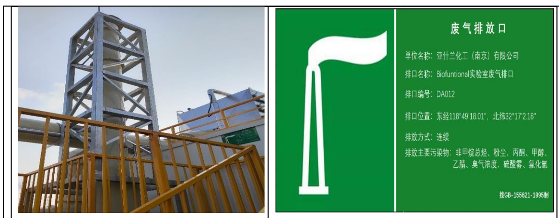
图 3-5 本项目依托现有排气筒及标识牌
